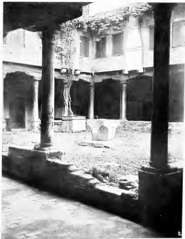
VENEZIA - Abbazia di S. Gregorio. Chiostro coi guasti recenti. Fig. 4.
